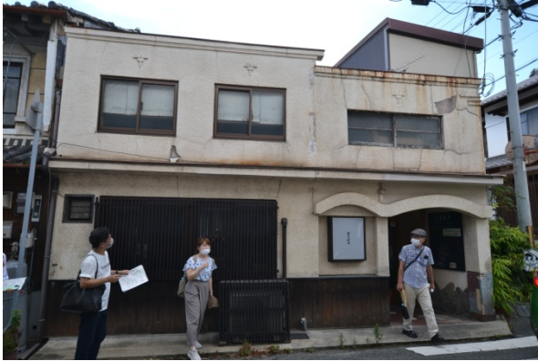
⑤ コミュニティスペース「ふるさと」 劣化が進んでいるので、今後追加改修予定
